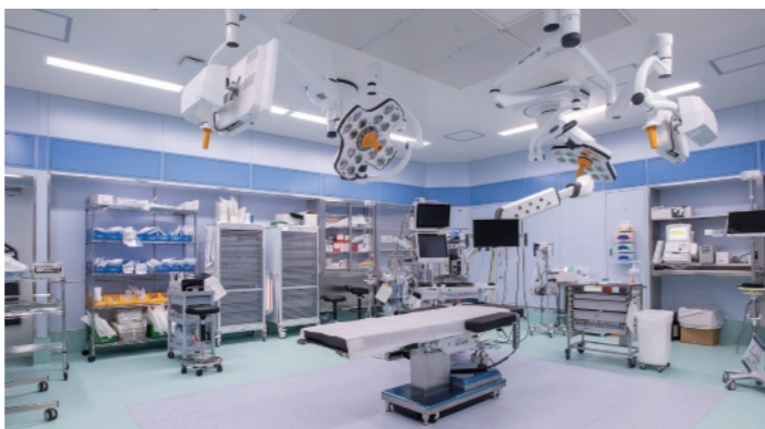
病院2階の手術室。救急だけでなく、様々な領域の手術に対応できる設備を整備しており、高度な急性期医療を提供している。
