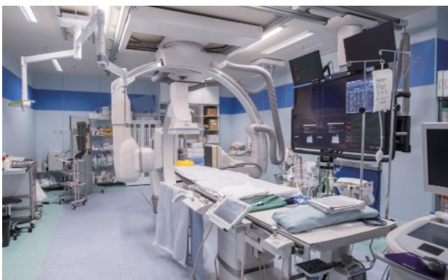
病院2階には血管撮影装置「Alphenix」のバイブレーション型の装置を設置。脳・心臓カテーテル検査や治療に対応し、内科的なカテーテル治療にも対応可能な設備を有している。
